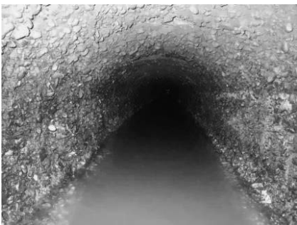
写真1 全体的に劣化が進んだ既設管の内部
